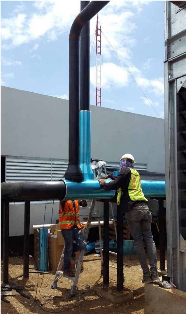
Conexiones de Torres de Enfriamiento
