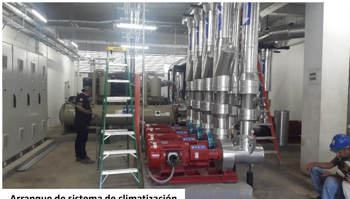
Arranque de sistema de climatización
